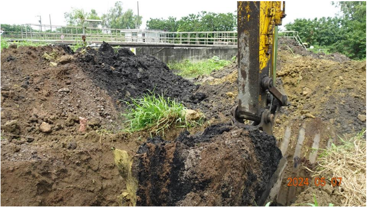
現場開挖出之回填污泥與原土明顯不同，且散發陣陣異味
